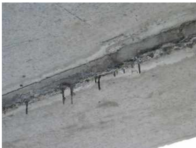
コンクリートに発生した石灰つらら
