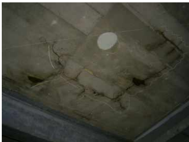
コンクリートスラブのひび割れ (内部から見たところ)
