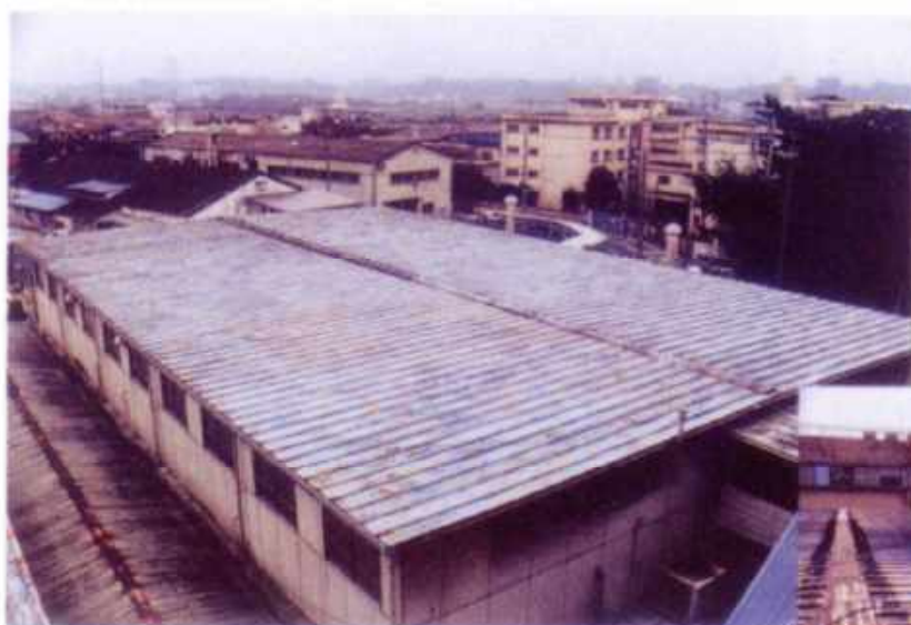
施工前 錆びがひどい状態 漏水も発生
