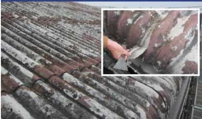
もとの塗装は完全に浮いて簡単にはがれる状態
